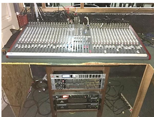
Ilustración 18. Equipo instalado en la congregación “Abba Padre” Fuente: Elaboración Propia
