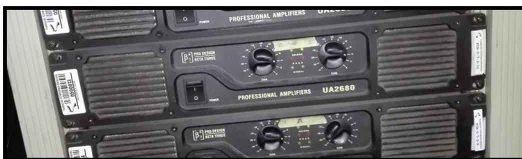
Figura 15. Amplificador de potencia tres UA2680, Canales CLF y LLF. (Elaboración Propia).
