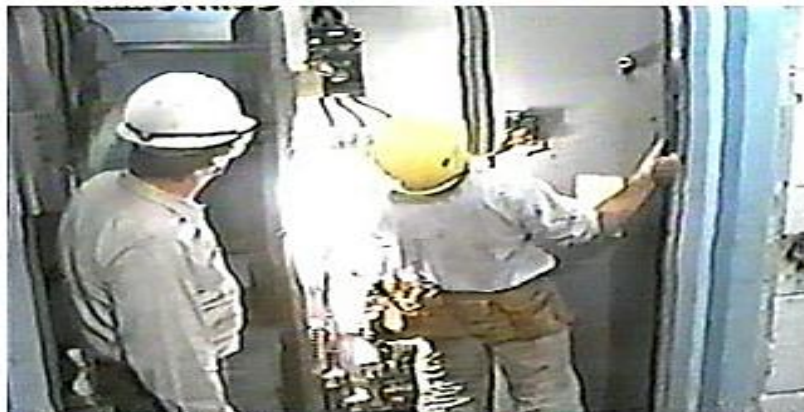
Figura 16. Personal trabajando en barras principales
