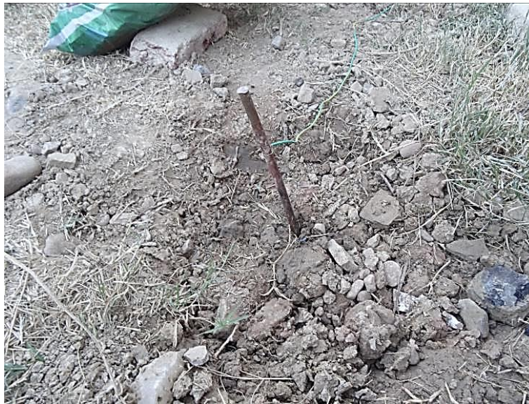
Figura 44. Tierra física tomada de las estructuras en los festivales Unitronica y Unirock 2019
