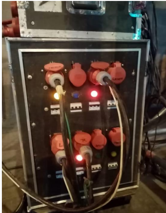
Figura 34. Distribuidor eléctrico 230 V-P. A. parte trasera
