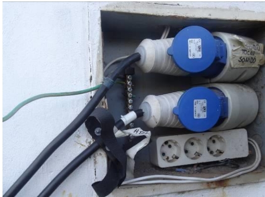
Figura 39. Salidas Cetac del tablero monofásico
