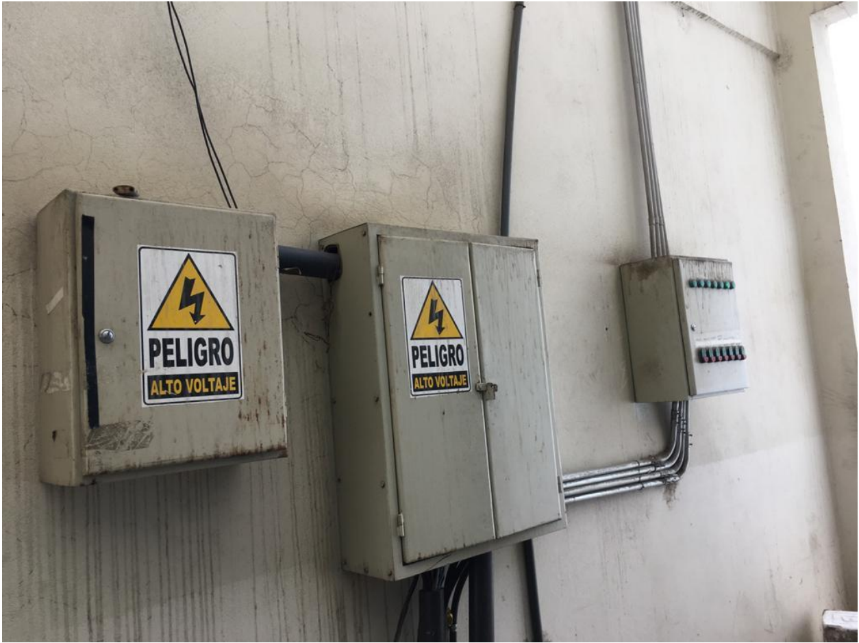
Figura 35. Tablero eléctrico, Teatro al aire libre Jaime Iaredo, La Paz
