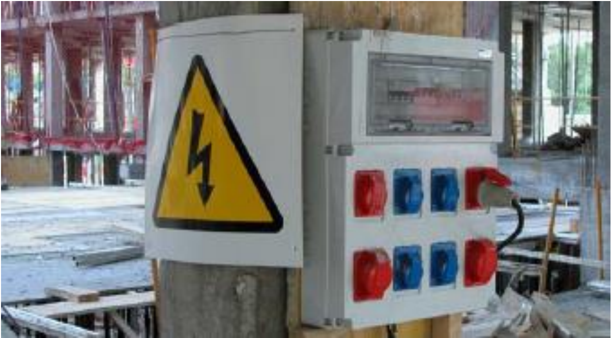
Figura 71. Cuadro eléctrico con conectores de salida CETAC
