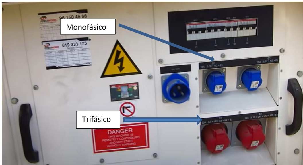
Figura 73. Conexión del grupo electrógeno mediante salidas Cetac en trifásico y monofásico
