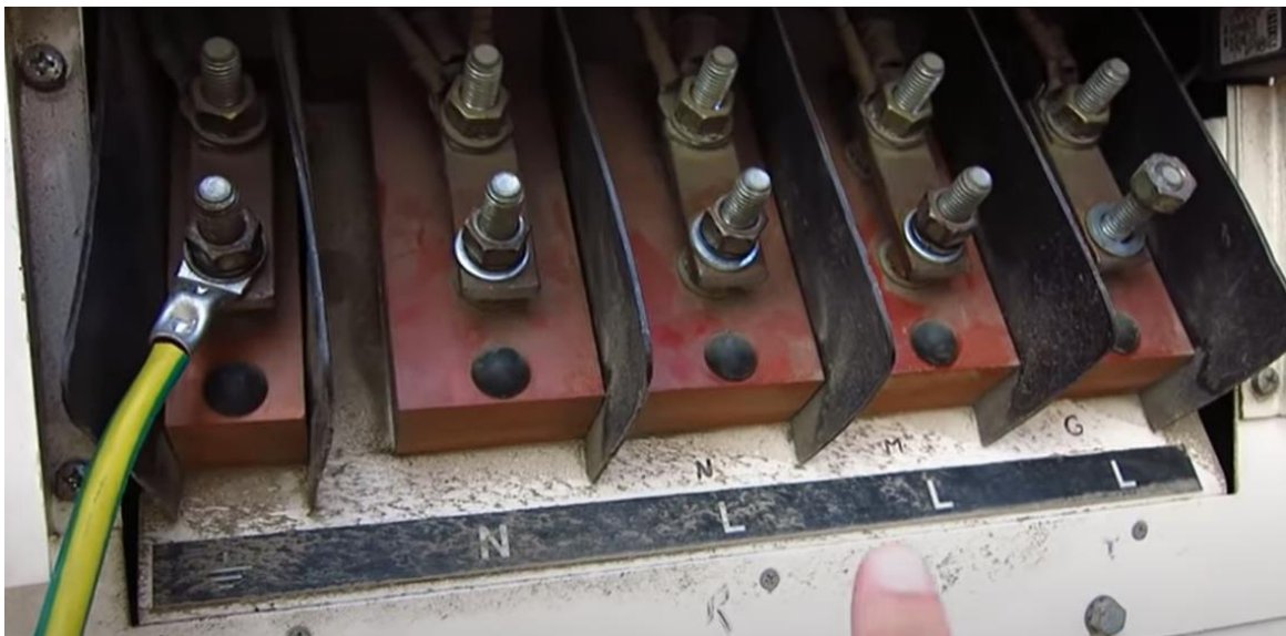
Figura 72. Conexión del grupo electrógeno mediante borna trifásica con cable pelado
